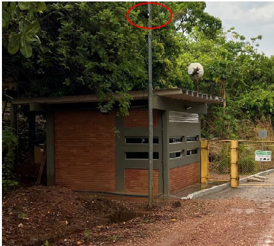
Figura 21 – Sirene instalada na sala de emergência.
