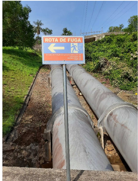
Figura 28 – Placa da rota de fuga da margem direita, próxima à casa de força.
